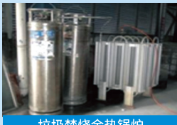
垃圾焚烧余热锅炉
