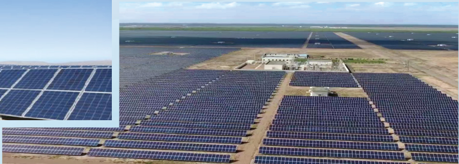
金泰电力200MWp并网光伏电站
