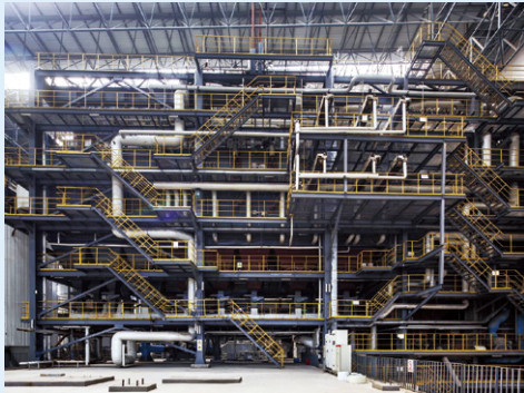
河北固安生活垃圾焚烧余热锅炉设计+供货项目
