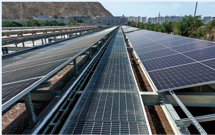
兰州雁儿湾污水厂分布式光伏电站
