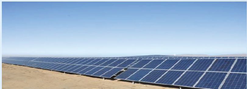
内蒙古额济纳旗30MWp并网光伏发电电站
