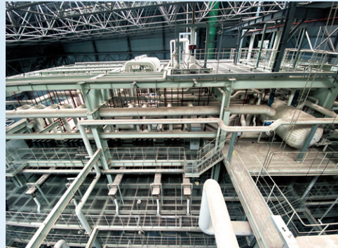
赣州南康生活垃圾焚烧余热锅炉设计+供货项目
