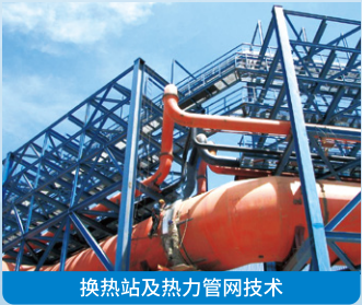
换热站及热力管网技术
