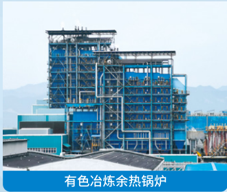
有色冶炼余热锅炉
