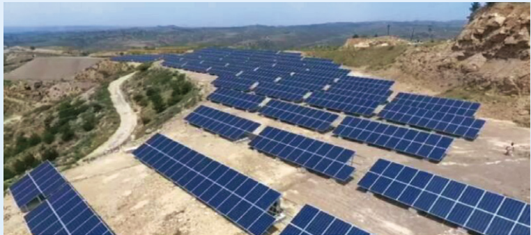
偏关县800kWp村级光伏扶贫电站
