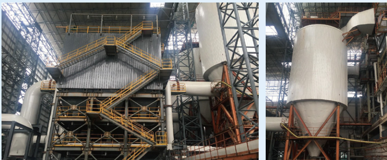
赣州生活垃圾焚烧发电厂项目(烟气净化EPC)
