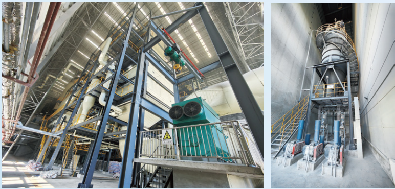
固安县生活垃圾焚烧发电厂项目(烟气净化EPC)
