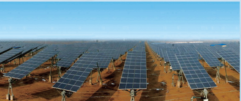
光伏发电项目
