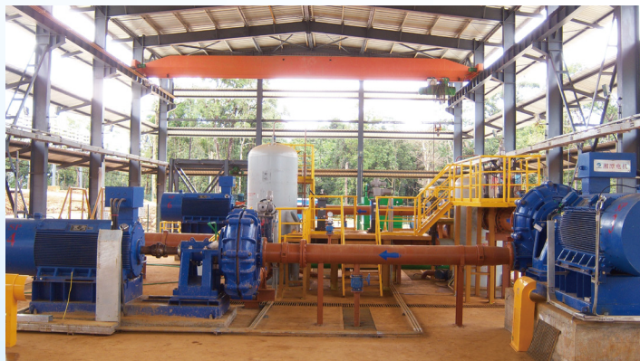
世界首条投运的镍钴矿浆体长距离管道输送工程 ——巴布亚新几内亚瑞木镍钴矿浆体长距离管道输送工程（EP） 输送镍钴原矿321万t/a，管道长135km，4级大流量离心泵 近距离串联输送
